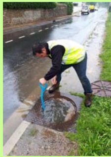
Laurent ouvre un déversoir.
